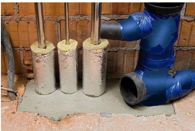
Bild 12 Die Vergussmasse einfüllen – fertig ist die sichere und letztendlich auch kostengünstigere Lösung.
