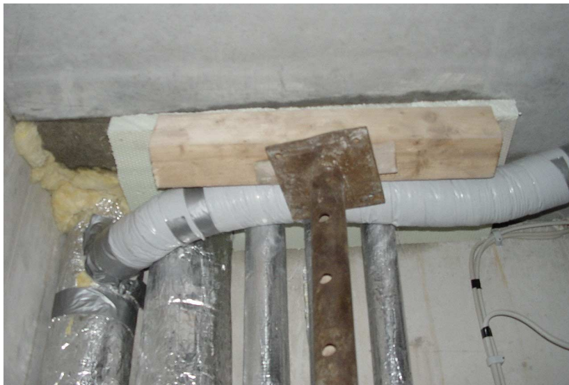
Bild 2 Nie wieder solche Konstruktionen, die nicht den Anforderungen des Brand- und Schallschutzes entsprechen.
